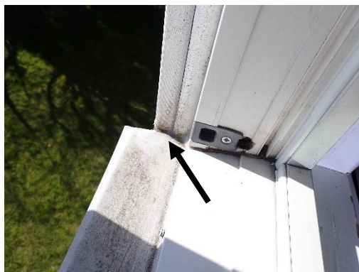
Ej uppvikt fönsterbleck
