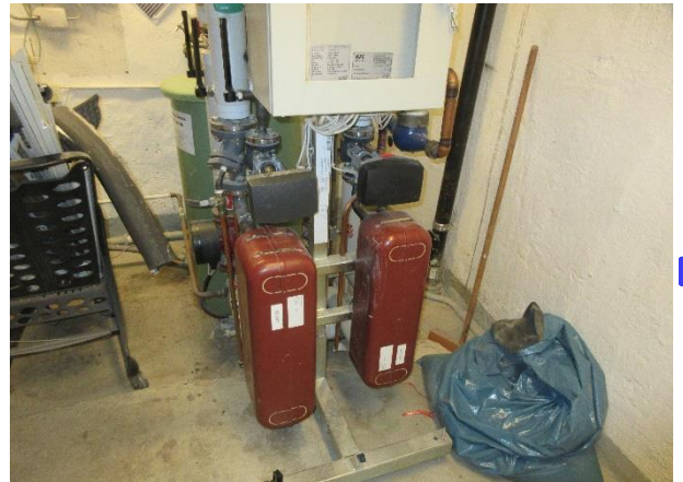
Undercentral för fjärrvärme.
