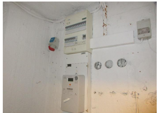
Modernare gemensam elcentral
