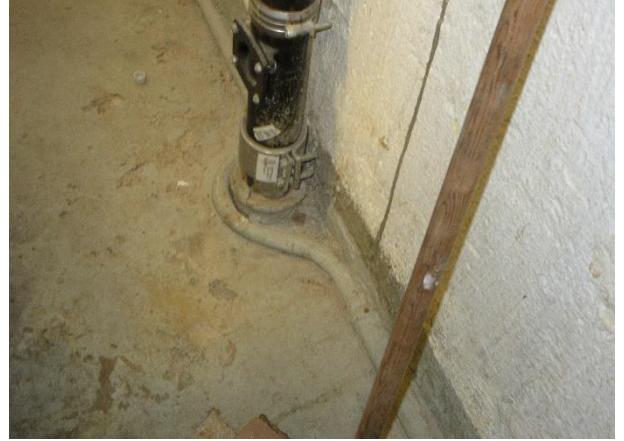
Avlopp under betongplattan ej utbytta
