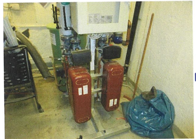
Undercentral för fjärrvärme.
