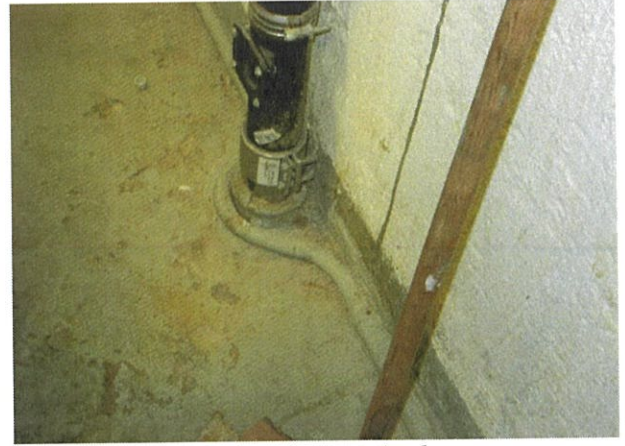
Avlopp under betongplattan ej utbytta
