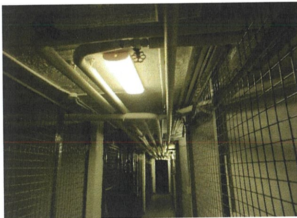
Gamla kranar på radiatorstigarna
