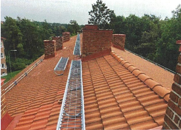
Yttertak med en del utbytta pannor
