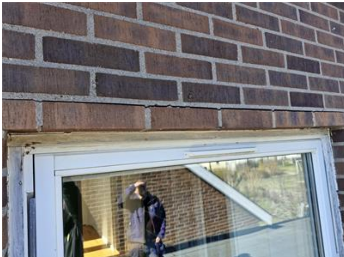
Fasad Tegel, tegelrad ovan fönster släppt.
