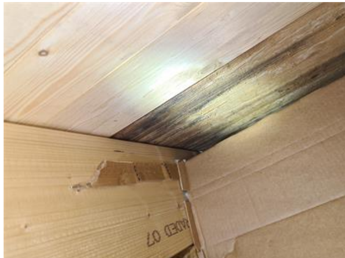
Sidovind, torra/äldre fuktanvisningar i underlagstaket.
