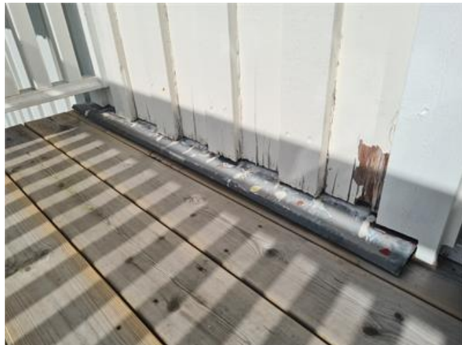
Fasad, fasadpanelen vid balkong har bytesbehov.
