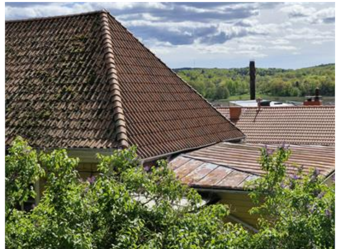
Tak, mossa på tegelpannor, rostangripen plåt på utbyggnad. Taket ej åtkomligt.
