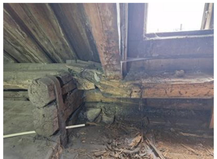
Nockvind, rötskada och förskjutning i bärande del vid takkupa.
