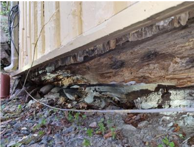
Utbyggnad norra gaveln, rötskador i syllstock och nederkant panel.
