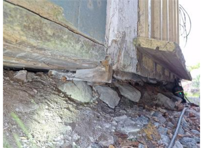
Utbyggnader, enklare grundkonstruktion på marken med rötskador i syllstockar och nederkant panel.
