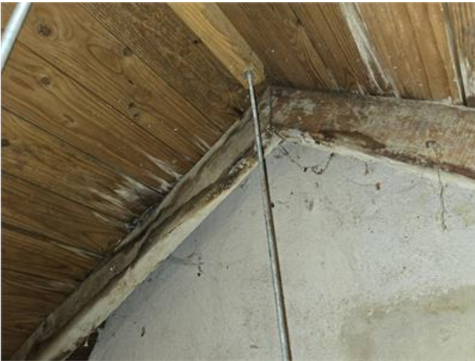
Äldre fuktanvisningar i träkonstruktioner på Nockvind.
