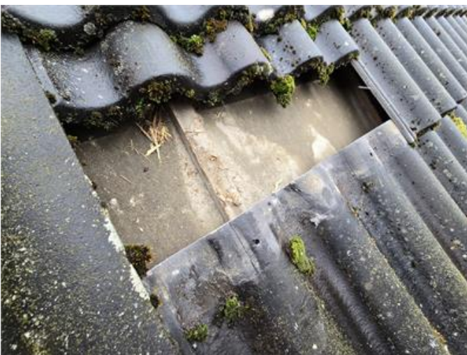
Spröd underlagspapp på äldre del av Tak.
