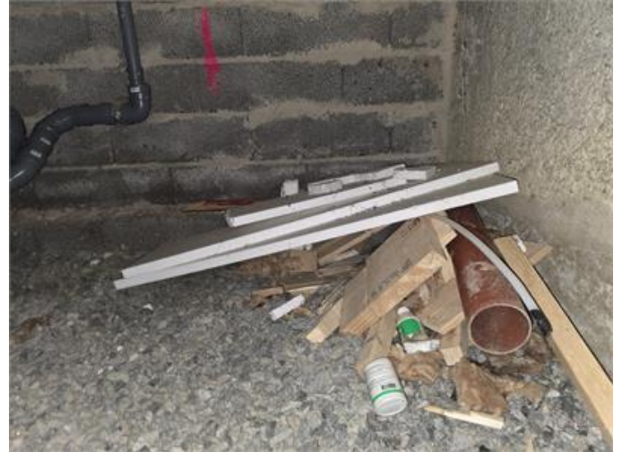
Byggspill i Krypgrund.
