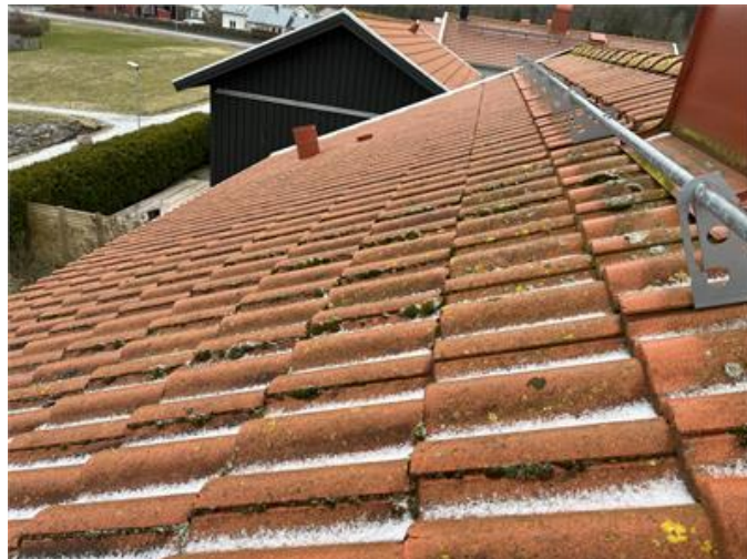
Tak, mossa på takpannor.
