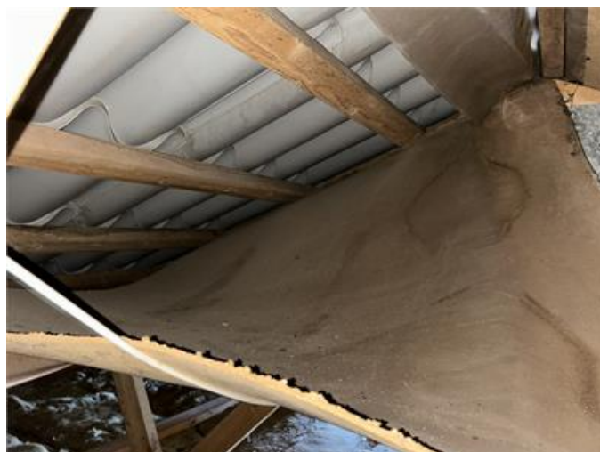
Nockvind: Underlagsskivor som lossnat från sitt rätta läge, Fuktanvisning samt Mikrobiellpåväxt
