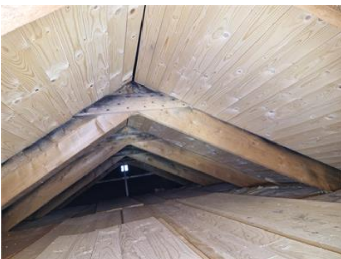
Nockvind, mikrobiell påväxt överkant av takreglar, ny råspont monterad 2020.
