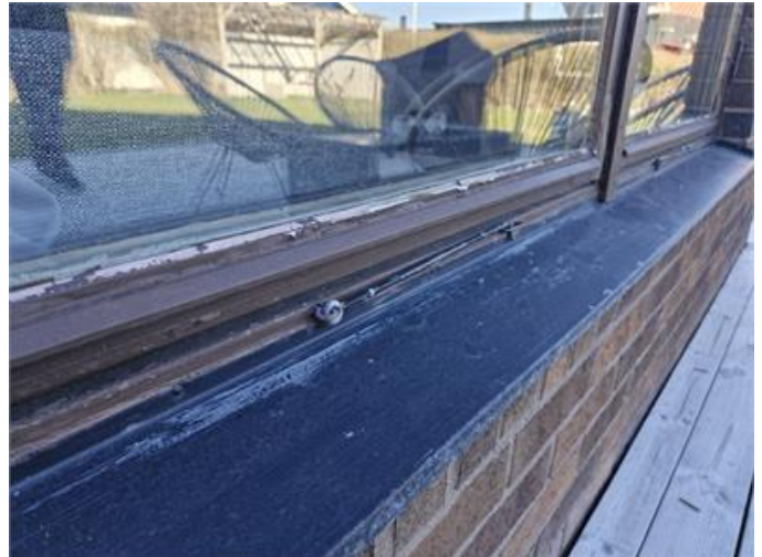
Fönster, äldre med färg- och kitsläpp.
