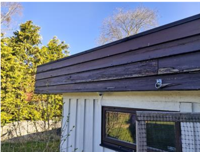
Taksarg Garage, rötskador förekommer.
