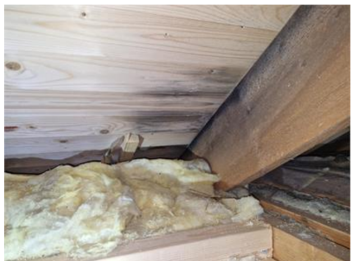
Nockvind, lokal mikrobiell påväxt på underlagstak vid vindsluckan.
