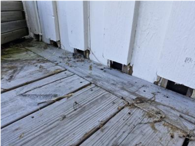
Fasad, otätheter garage vid altan.
