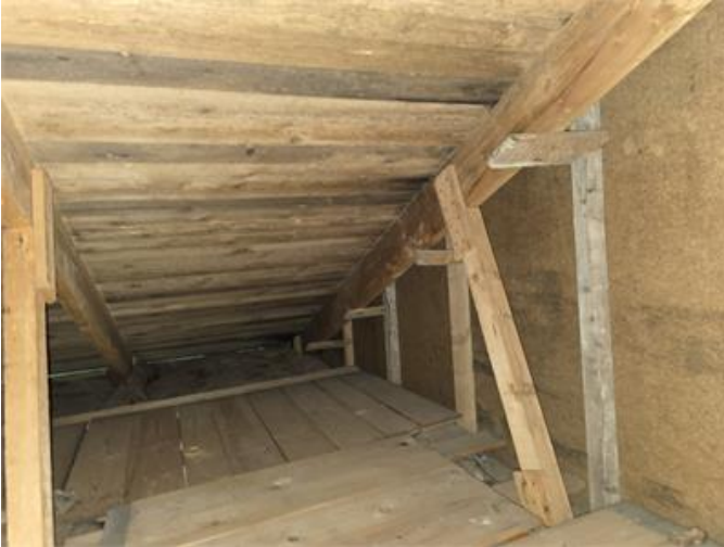
Mikrobiell påväxt/missfärgning i underlagstaknockvind.
