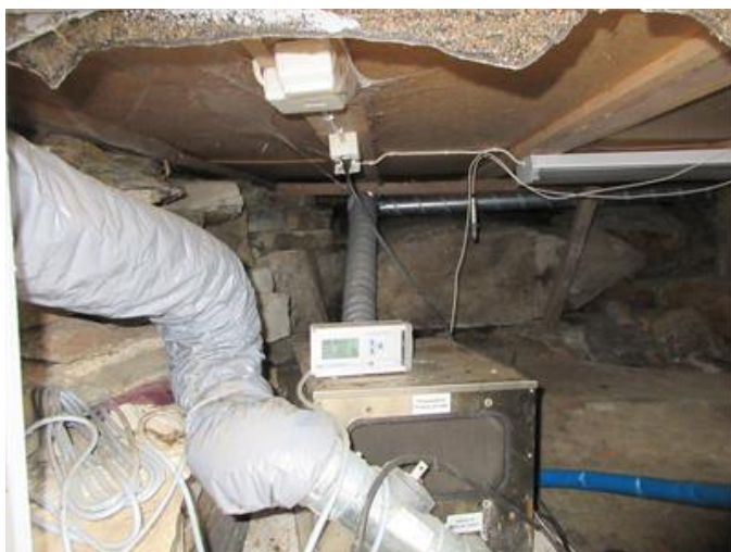
Avfuktare i krypgrund
