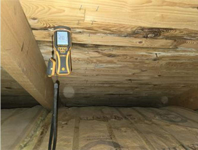
Nockvind: Fuktbläckar i underlagstak.
