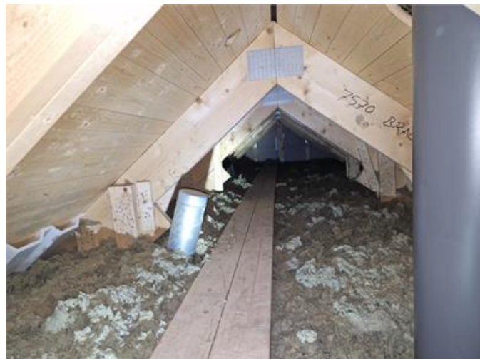
Nockvind, oisolerad del av ventilationsystemet.
