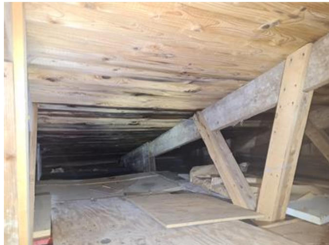
Nockvind Garage, fuktgenomslag.
