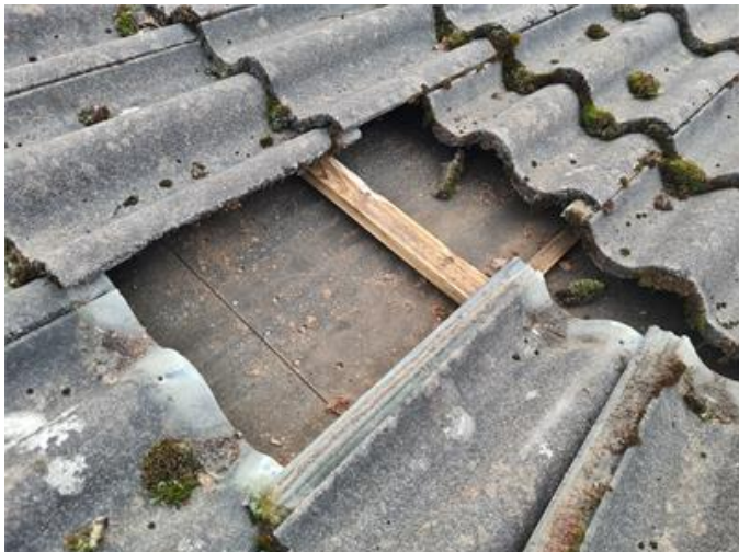
Tak Garage, äldre/original med läckage.
