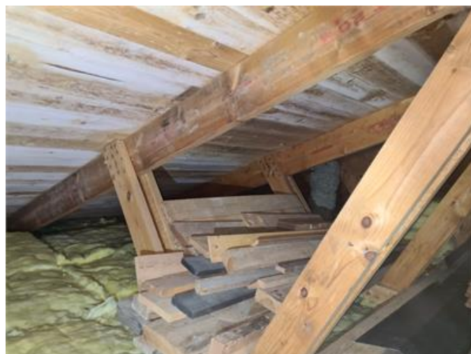
Nockvind Bostad, mikrobiell påväxt på underlagstaket (konvektionsskada).
