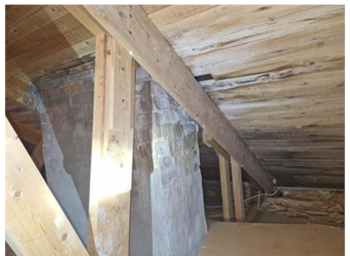
Nockvind, torra fuktanvisningar runt murstock.
