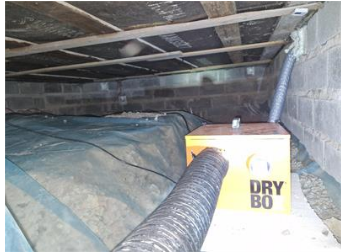
Krypgrund, avfuktare finns installerad.
