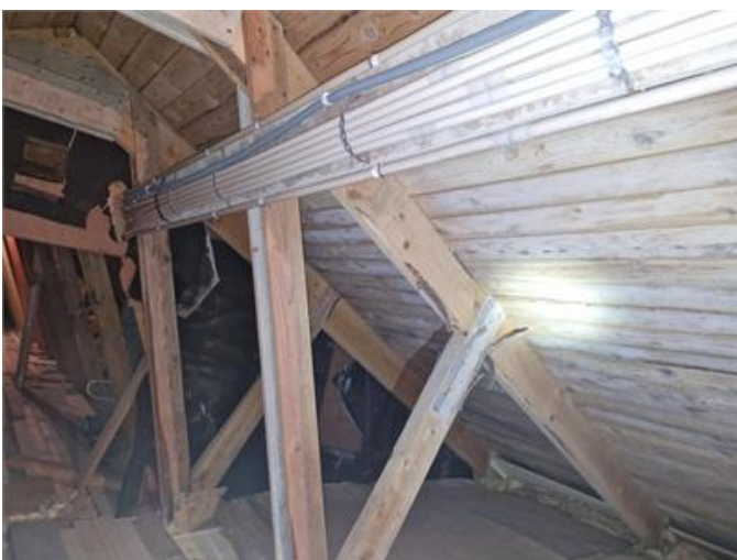
Nockvind, vitaktig mikrobiell påväxt i underlagstaket, oisolerad eldragning.
