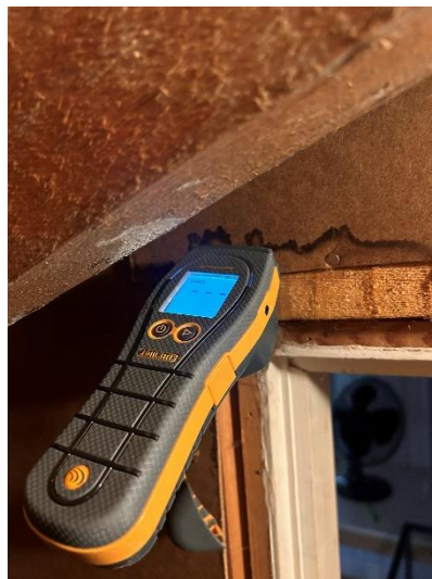
Fuktmärken vid dörren in till vinden inget utslag. "mäter inte under 7%"
