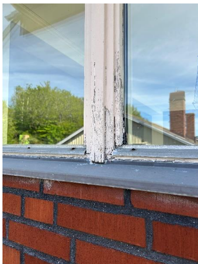
Bytes behov av 2st fönster på gaveln.
