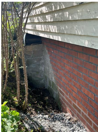
Puts saknas på den tillbyggda förrådsdelen.
