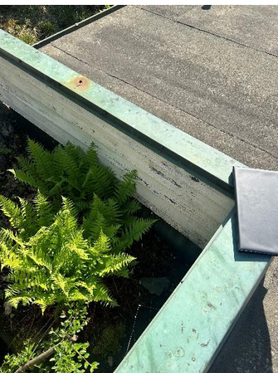
Underhåll/bytes behov av taksarg.
