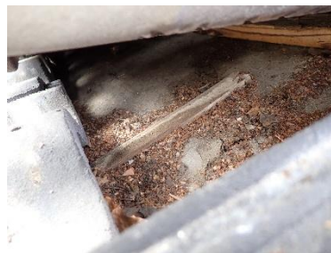
Bristande underliggande läkt.
