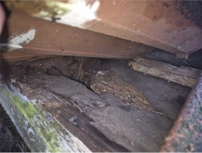
Rötskada i takutsprång.
