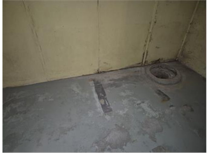
I ett källarrum förekommer utreglade väggar som är fukt/rötskadade. Det utreglade väggarna rekommenderas tas bort och kasseras.
