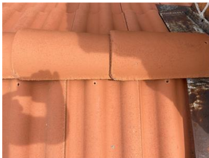
Spikhål synliga på övre rad takpannor.
