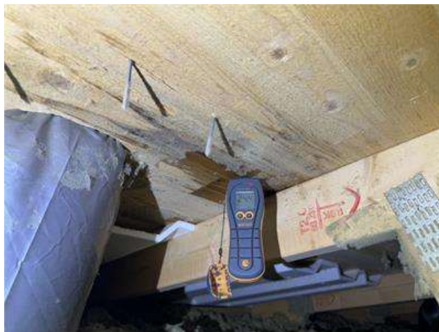
Begränsat takläckage på vindens underlagstak.
