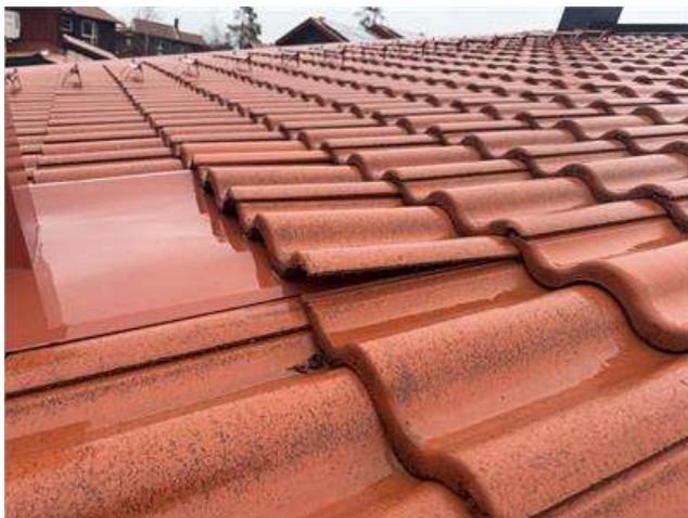
Bilden visar takpanna som glipar vid plåtanslutning.
