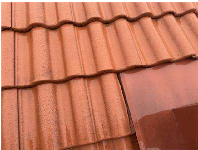
Trasig takpanna ovan läckage som noterats på vindsutrymme.
