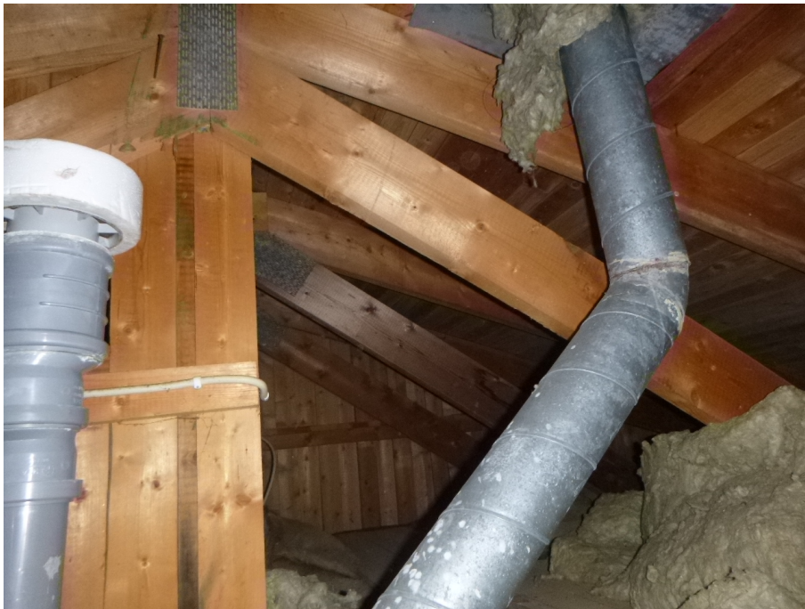
Kondensisolerings saknas runt frånluftskanal.
