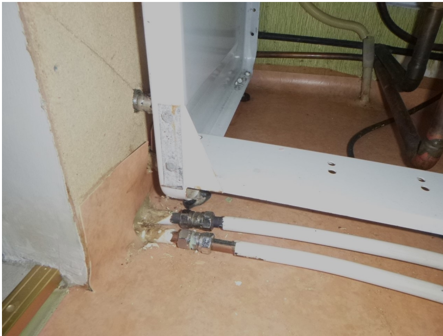
Rör genomföring under varmvattenberedare.
