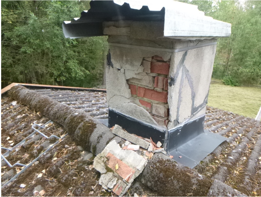
Otätthet intill skorstensbeslag.
