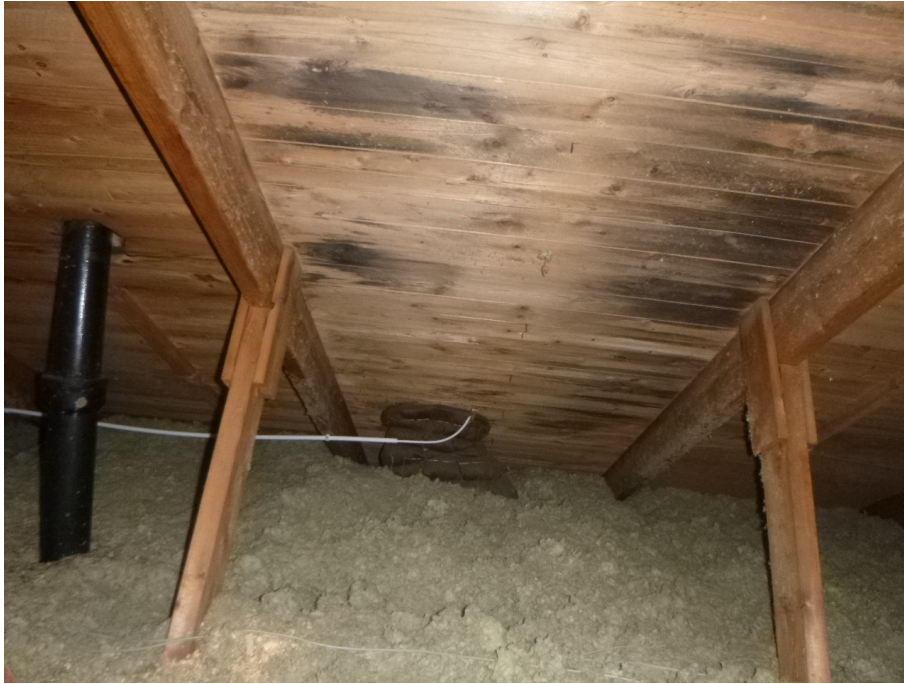
Mikrobiell påväxt/missfärgning på underlagstak, vindsutrymme.
