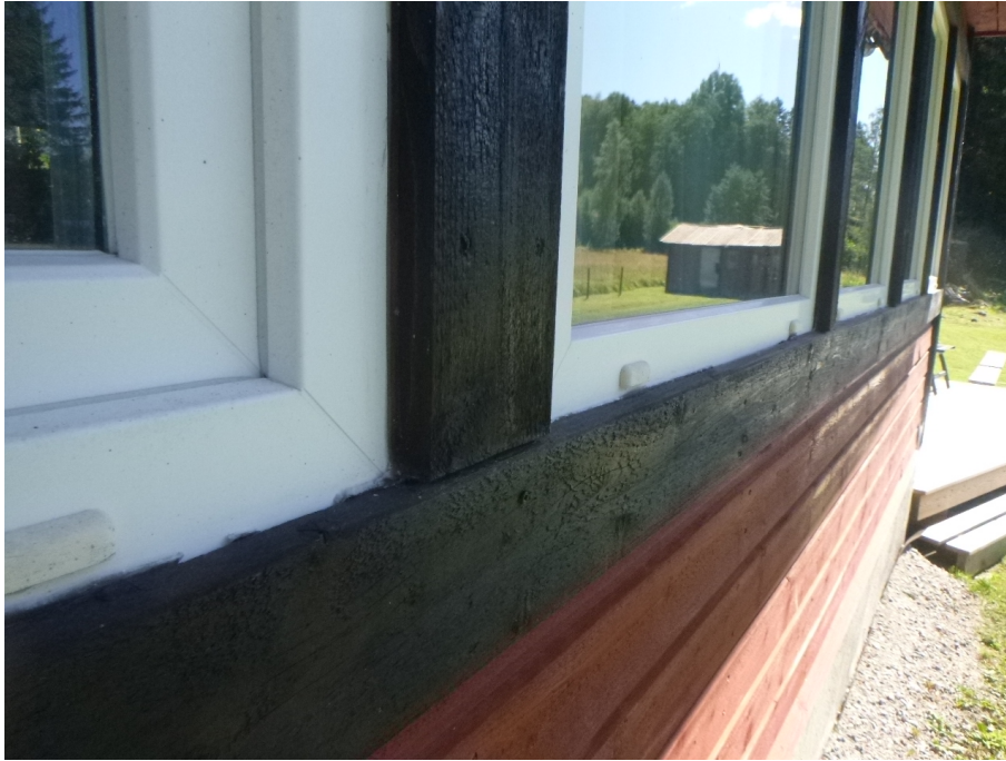
Avsaknad av fönsterbleck.
