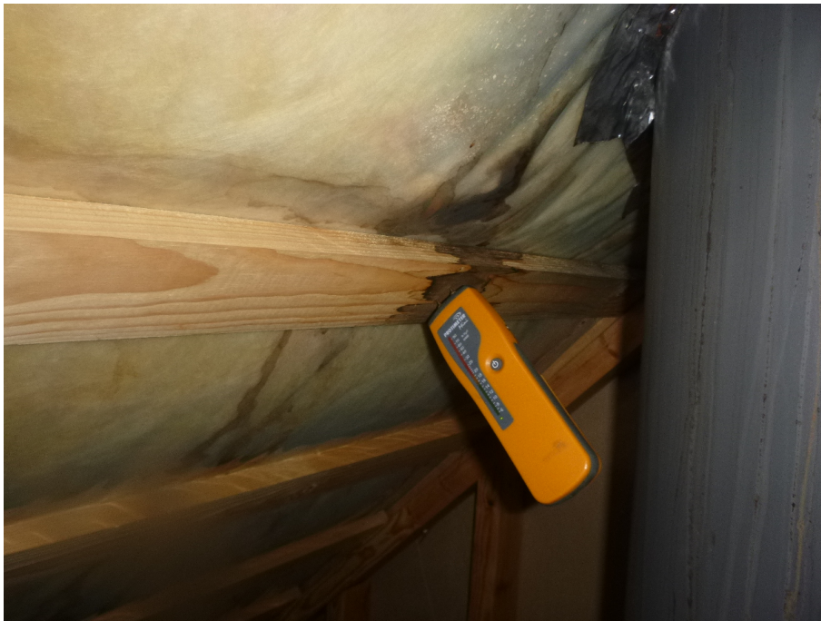
Missfärgning/fuktanvisning bakom ångspärr intill skorstensrör, vindsutrymme.
