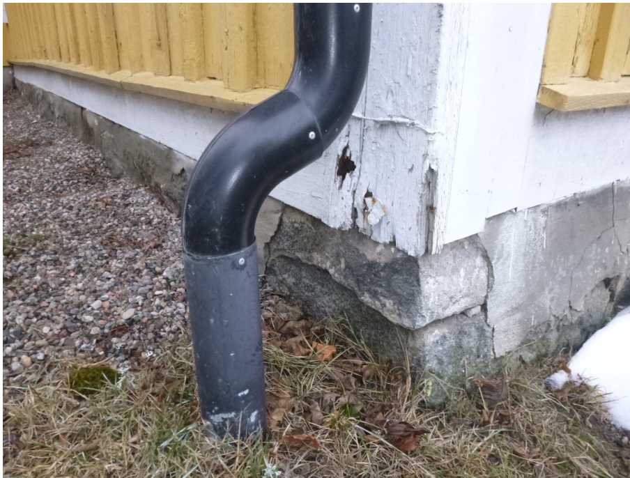
Anslutning mot markledning, rötskada knutbräda.
