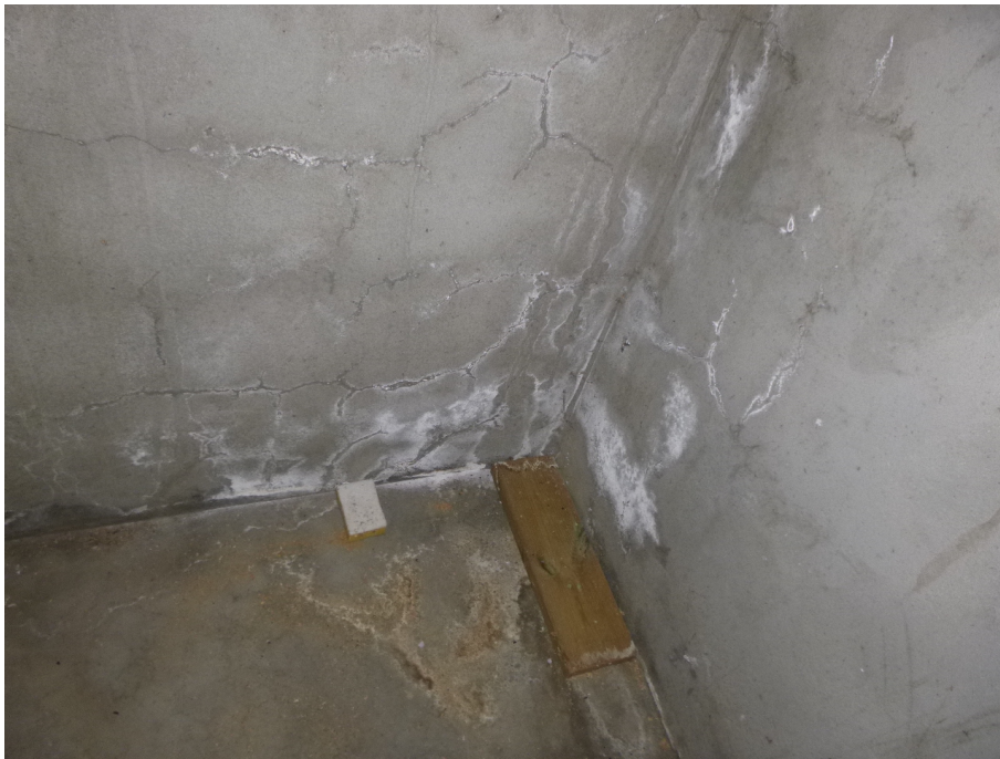
Saltutfällning trappa mot garage.
