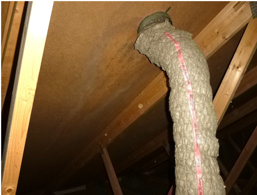
Lokal fuktanvisning/missfärgning intill frånluftsgenomföring, vindsutrymme.
