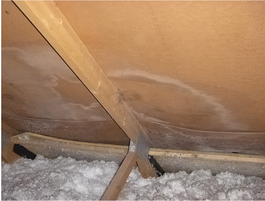
Fuktanvisning/missfärgning boardskivor, vindsutrymme.
