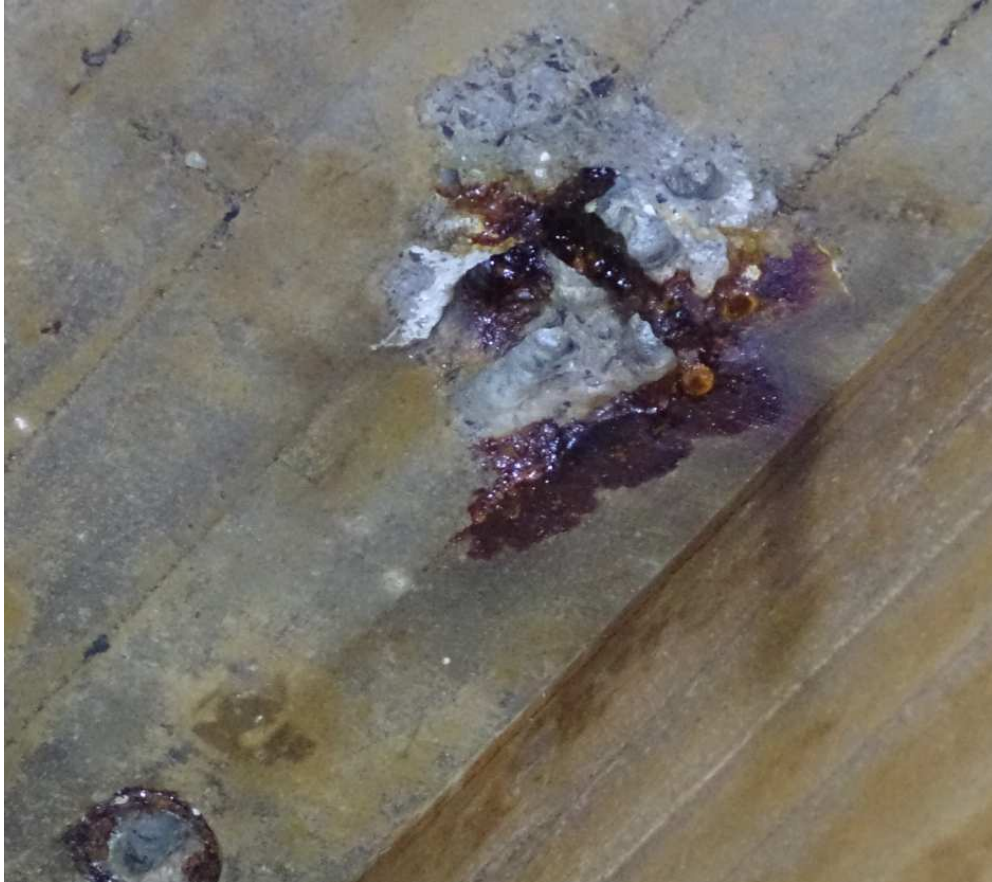
Figur 10 Mindre skada på betong vid schakt.
