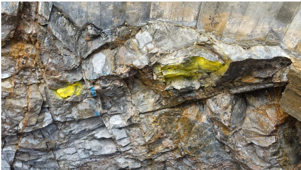
Figur 2 Två lösa/bomma block i tak nära portal.
