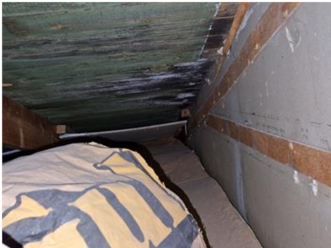
Missfärgning på rote på vinden.
