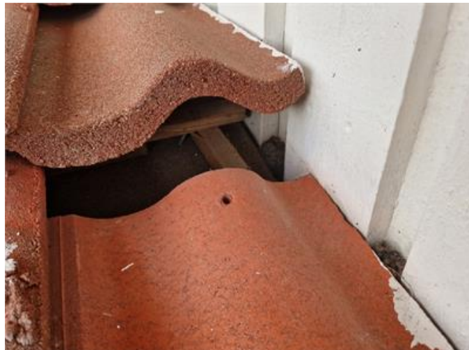
Anslutning mellan lågdelens tak och fasadpanelen är bristfälligt utförd.
