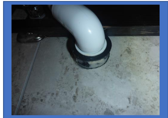
Bild 8: Otät rör genomföring vägg under handfat
