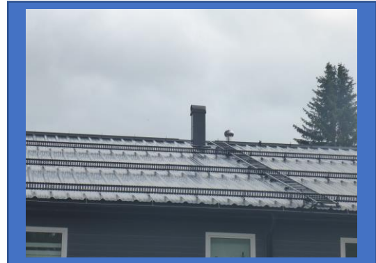
Bild 2: Kragplåt skorsten med glipa/otäthet mellan takplåt och krage.
