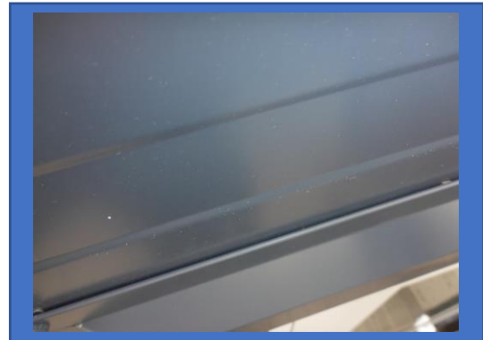
Bild 4: Otätheter plåt på fasad.
