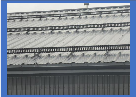
Bild 1: Skadade infästningar snörasskydd.
