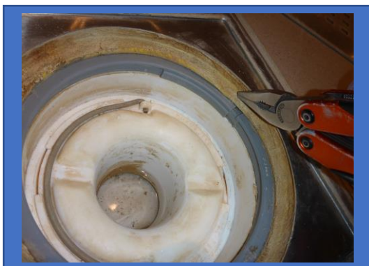
Bild 11: Hål i brunsmanschett samt ej anläggning mot underlag, brunsmanschett buktar ur över klämring.
