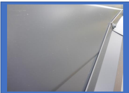
Bild 5: Otätheter plåt över fönster.
