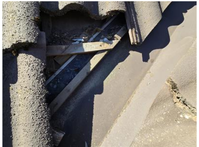
Tak: Löv/frömjöl under pannor vid rännal. Läkt monterad/spikad i rännal med risk för rötskador på läkt samt vatteninträängning vid genomföring.
