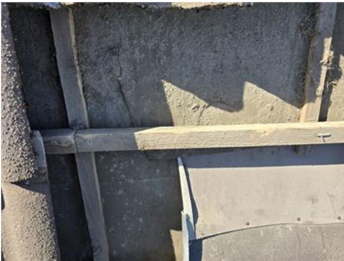
Tak: Skador i äldre underlagpapp vid stickprovskontroll under pannor.
