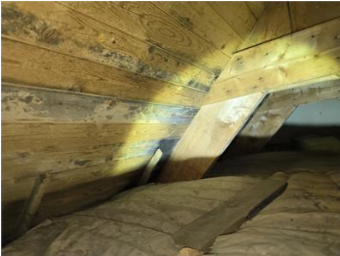
Nockvind: Mikrobiell påväxt/missfärgningar i underlagstak.
