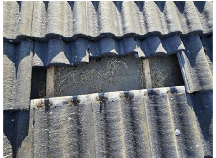
Tak: Stickprovskontroll under pannor, spår av fågelbon noteras.
