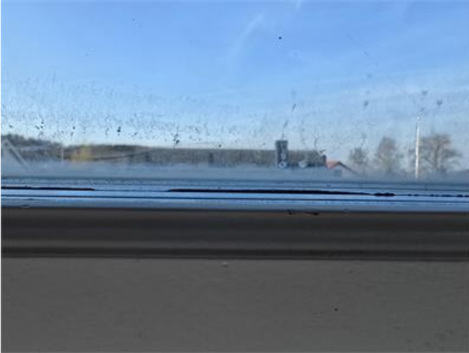
Fönster: Missfärgningar noterades i fönsterglas på övreplan.
