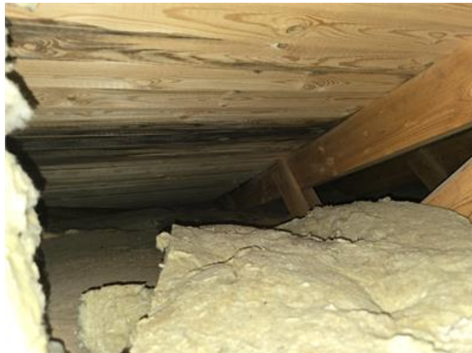
Nockvind: Missfärgningar i underlagstak.
