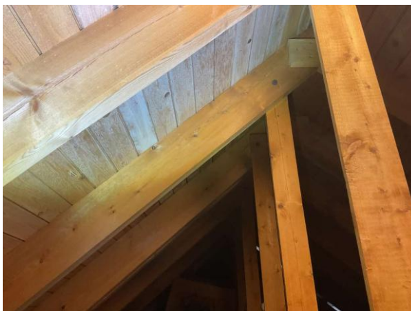
Bild 2: - Utvändigt, Vind, Lokalt noteras mikrobielpåväxt på underlagstaket
