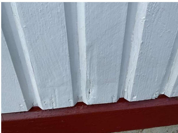
Bild 1: Utvändigt, Fasad, Torrspäckad Rötskador noteras i fasad
