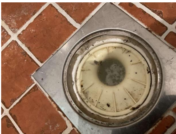
Bild 4: - Invändigt, Entréplan, Äldre våtrum sättbruk döljer anslutande tätskikt
