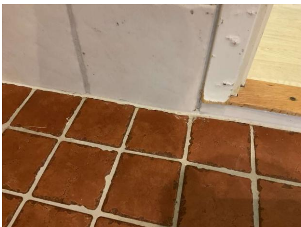
Bild 3: - Invändigt, Entréplan, Äldre våtrum Dörren är olämpligt placerad i duschzonen Svällskadat dörrfoder
