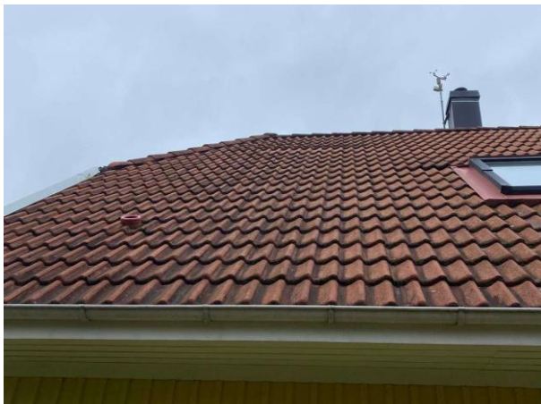
Bild 1: Utvändigt, Yttertak, Enstaka pannor ligger något ojämnt på framsidan av taket
