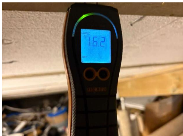
Bild 1: Utvändigt, Grund, Uteluftventilerad krypgrund, Uteluftventilerad krypgrund är en känd riskkonstruktion, se riskanalys. För att denna grundläggning inte skall klassas som en riskkonstrukti...
