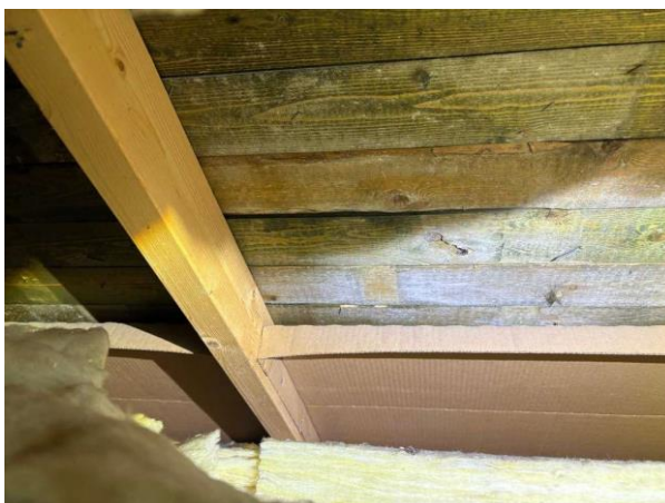
Bild 2: Utvändigt, Vind, Lokalt noterades mikrobiell påväxt noterades på underlagstaket (delar av råspånten är tryckimpregnerat virke) Vinden ovanför lilla delen av...
