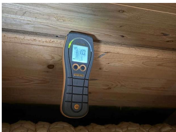
Bild 3: Utvändigt, Vind, Lokalt noterades mikrobiell påväxt noterades på underlagstaket (delar av råspånten är tryckimpregnerat virke) Vinden ovanför lilla delen av...
