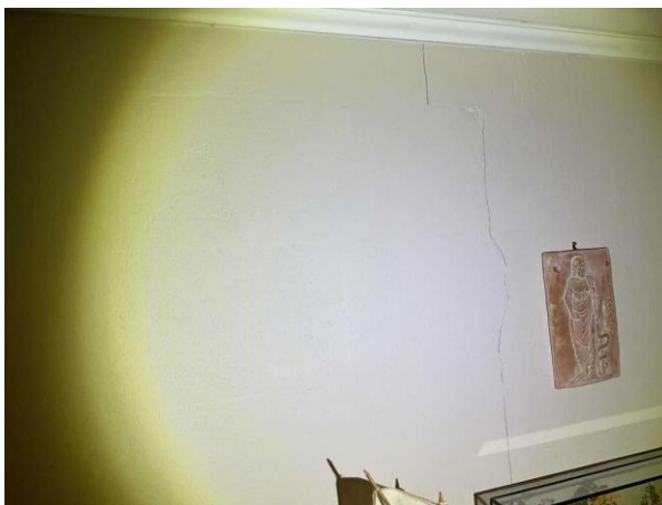
Bild 4: Invändigt, Källarplan, Sovrum 1, Sprickor noteras på yttervägg
