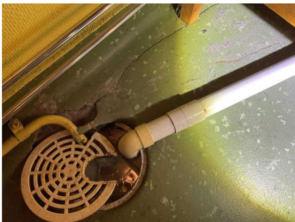
Bild 3: Invändigt, Källarplan, Tvättstuga, Äldre våtrum Plastmatta på golv Det förekommer rörgenomföringar i golv för annat än avlopp Klämringen i golvbrunnen är lös hål noteras på golvet
