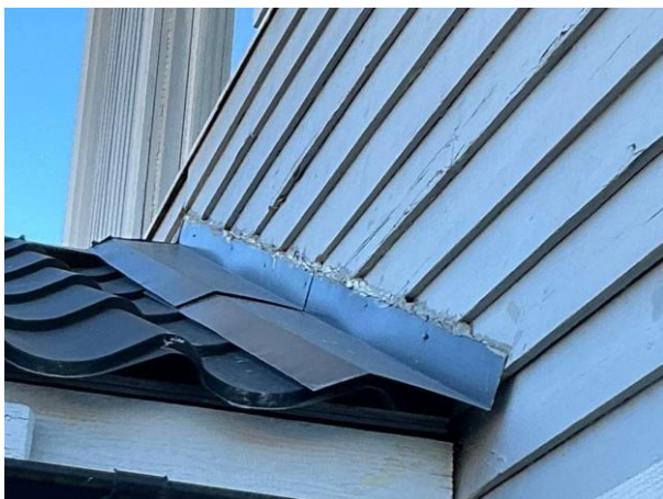
Bild 3: Utvändigt, Fasad, Torrspäckor och färgsläppen noteras. Ståndplåt mot fasad på tillbyggd entré ej infräst bakom fasad
