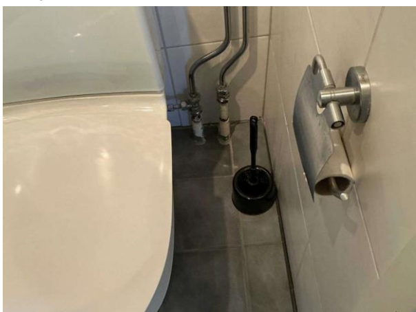
Bild 11: Invändigt, Övervåning, Badrum, Äldre våtrum se riskanalysen Det förekommer rör genomföringar i golv annat än för avlopp Golvbrunnen är inte utbytt vid renovering Klämring...
