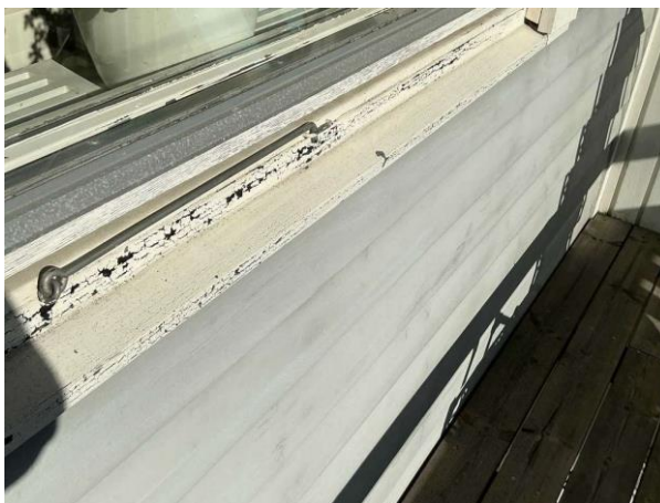
Bild 4: Utvändigt, Fönster, Färg och kittsläpp noteras på fönster. Fönsterbleck saknas på tillbyggnad entré
