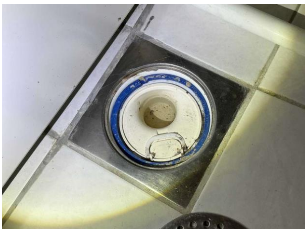
Bild 9: Invändigt, Entréplan, Tvättstuga, Äldre våtrum se riskanalysen Tätskikt/brunn duk saknas i golvbrunn Det förekommer rör genomföringar i golv annat än för avlopp Sk bomgolv not...
