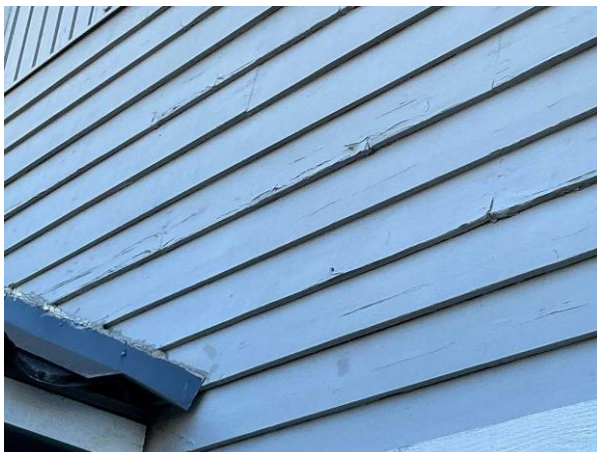
Bild 2: Utvändigt, Fasad, Torrspäckor och färgsläppen noteras. Ståndplåt mot fasad på tillbyggd entré ej infräst bakom fasad
