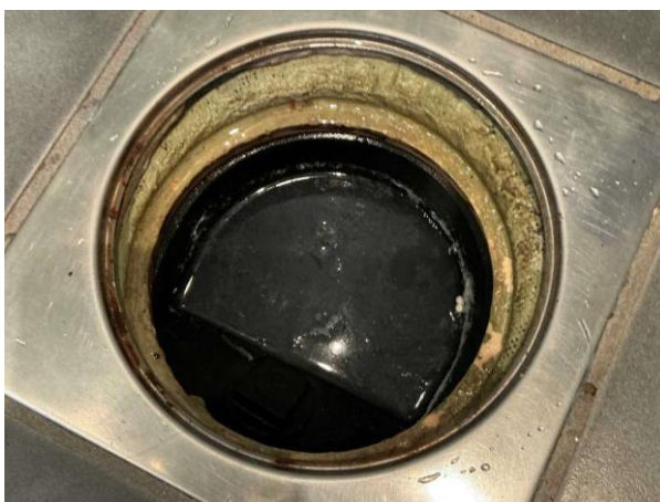
Bild 12: Invändigt, Övervåning, Badrum, Äldre våtrum se riskanalysen Det förekommer rör genomföringar i golv annat än för avlopp Golvbrunnen är inte utbytt vid renovering Klämring...
