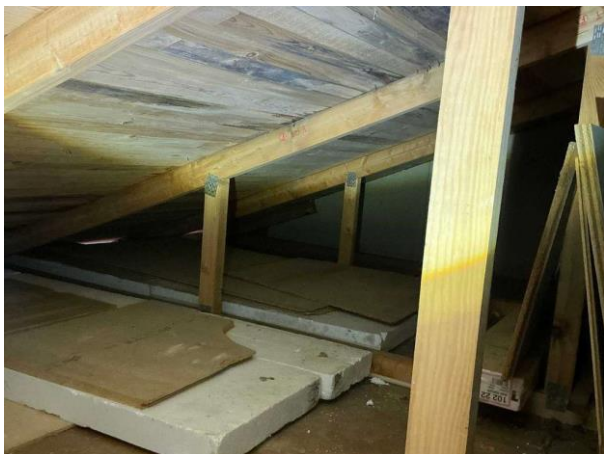
Bild 13: Invändigt, Inredd vind, Kattvind 1, Spår av äldre läckage noterades på underlagstaket (torrt vid besiktning) uppstod innan takomläggning
