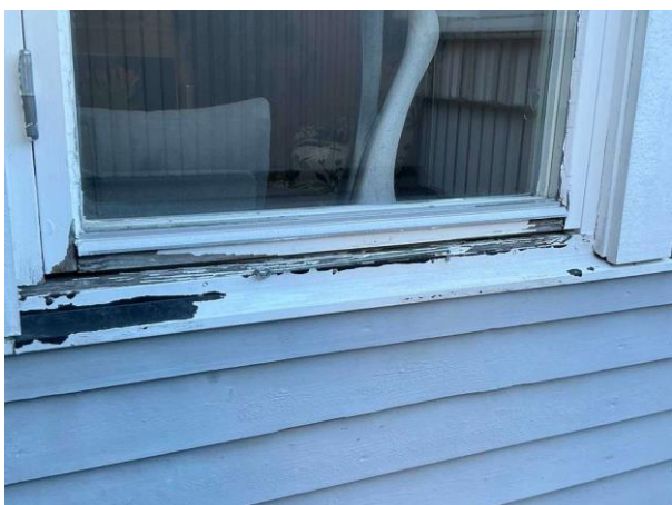
Bild 5: Utvändigt, Fönster, Färg och kittsläpp noteras på fönster. Fönsterbleck saknas på tillbyggnad entré
