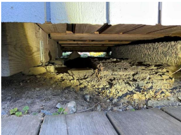
Bild 1: Utvändigt, Plintgrund under entre, Plintgrunden är marknära vilket kan påverka bjälklagsbotten med markfukt
