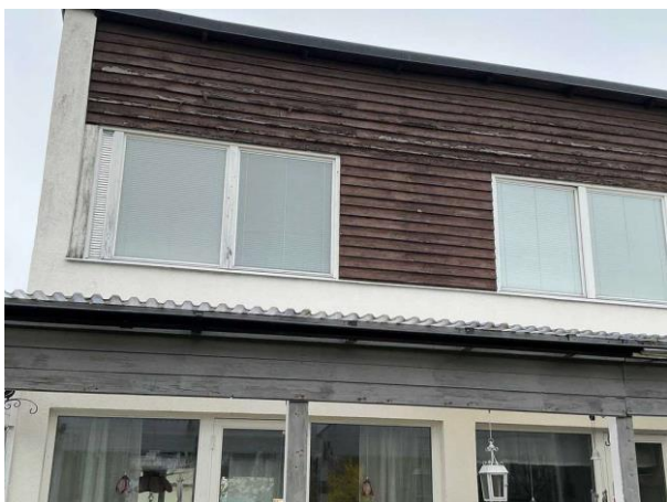
Bild 1: Utvändigt, Fasad, Urslag i betong runt fönsterbleck Sprickor i puts noterades på baksidan Träpanel på baksidan är i behov av byte
