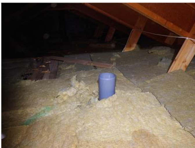
Även avloppsluftningen mynnar i vindsutrymmet.
