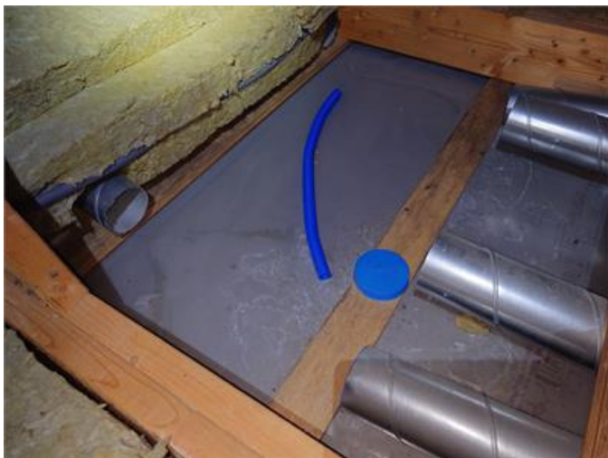
Ventilation från våtrum och kök mynnar i vindsutrymmet.
