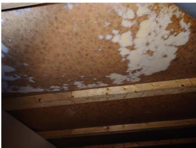
Svamp och mikrobiell påväxt förekommer på blindbotten, läkt, mm.
