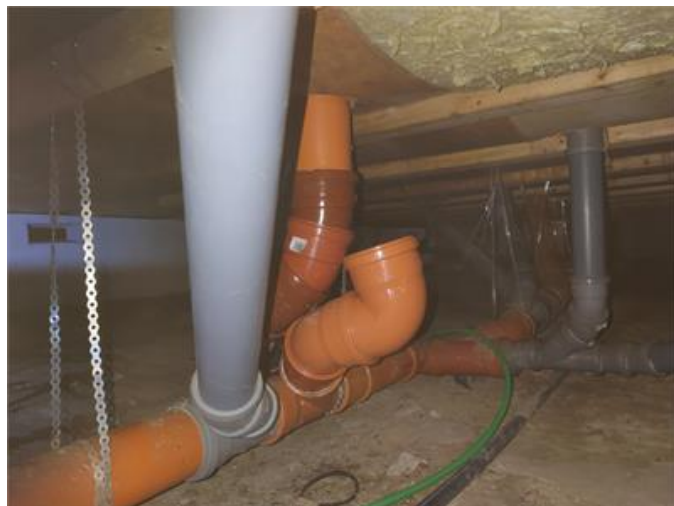
Avlopp mynnar i krypgrunden innebärande ökad risk för fukt och lukt.
