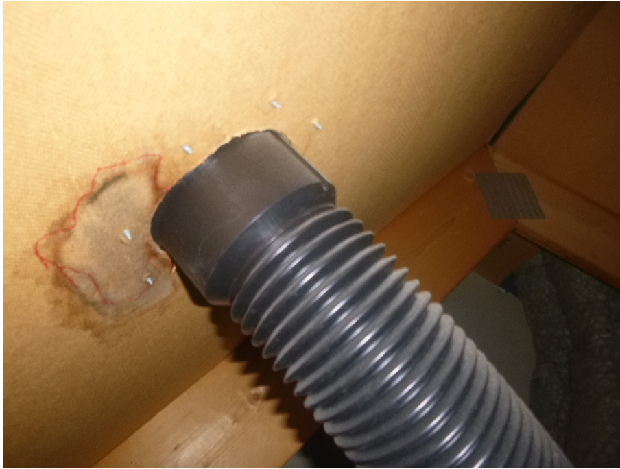
Fuktanvisning/missfärgning boardskiva, vindsutrymme.
