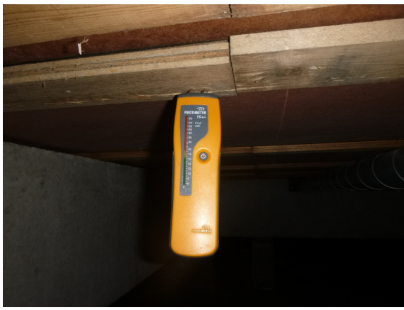
Fuktkvotsmätning i trossbotten, krypgrund.
