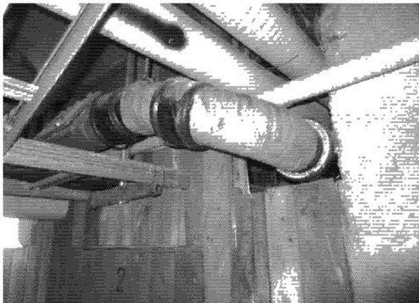
Lagade avloppsrör från nybyggnadsåret
