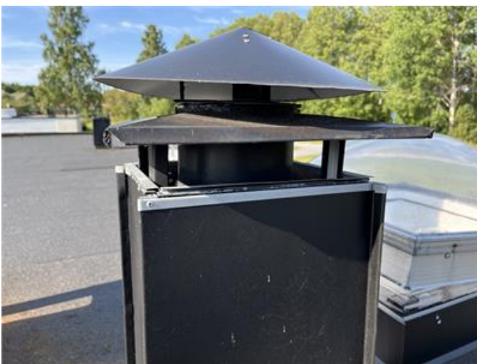
Viss otäthet mellan huvn och ventilationskanal där risk att regnvatten kan tränga in.
