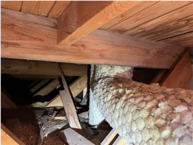
Lokal fuktfläck som noteras i underlagstaket.
