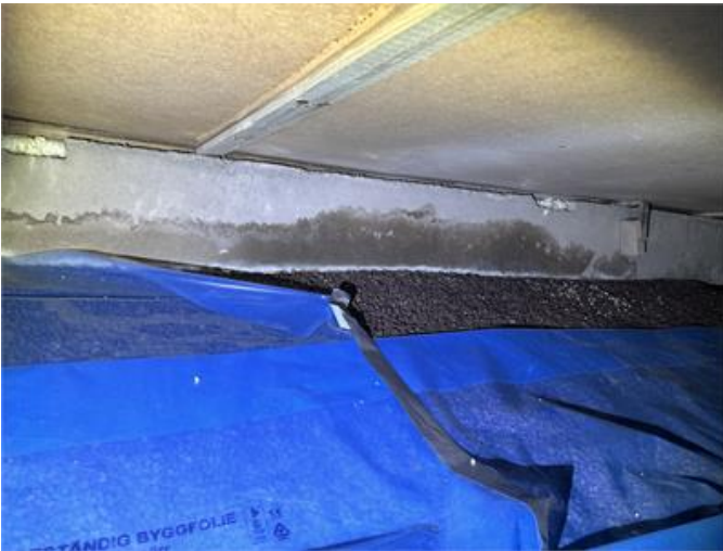
Fuktuppsug på grundbalk och markplast som kan justeras.
