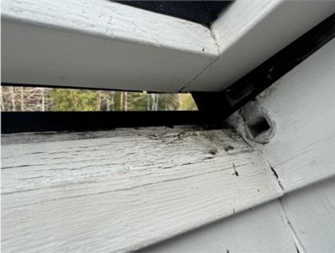
Bild visar karm till takfönster som är fuktpåverkad.
