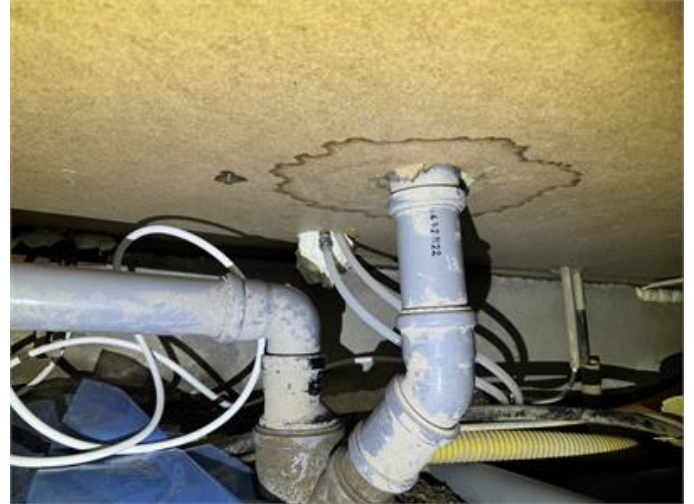
Fuktfläck runt avloppsrör i krypgrunden.
