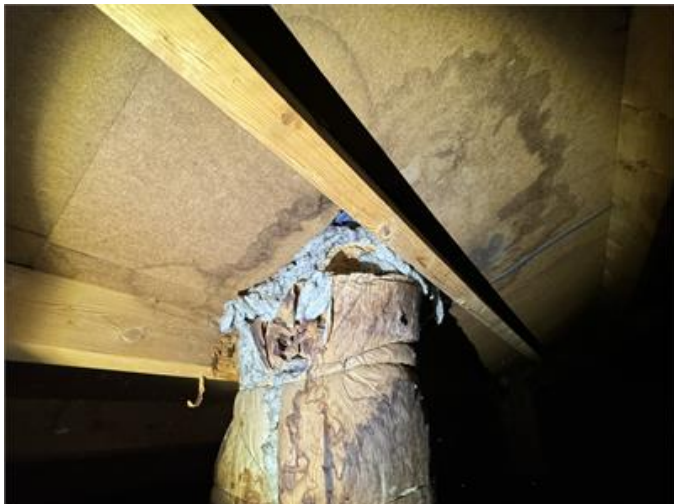
Fuktrosor på vindens boardskivor.
