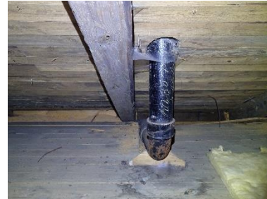
Äldre avluftningsrör av gjutjärn.
