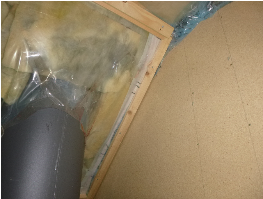
Isolering missfärgad intill genomföring skorstensrör.
